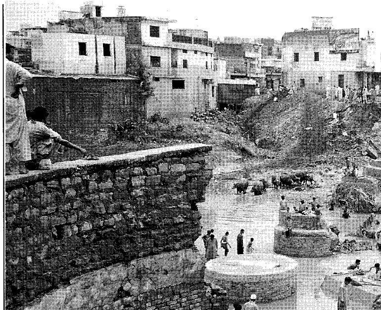
洪水から2日後、橋脚が切断されてしまった
