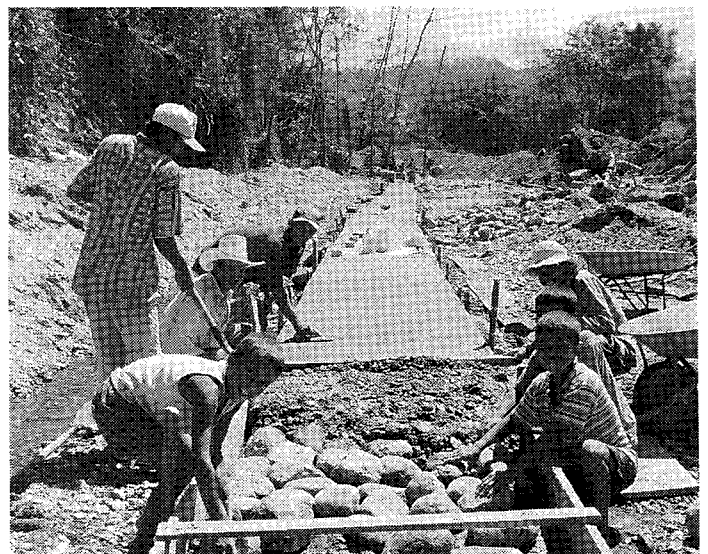
受益農家の子供たちまでが、洪水で流失した箇所の水路底板の復旧をしている。
