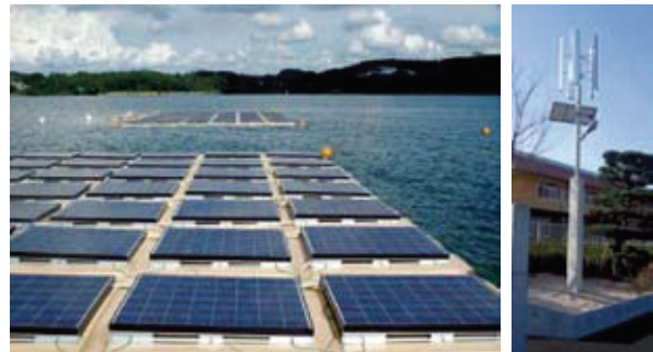
写真2-2 ため池を利用した太陽光発電(左) 小型風力発電設備(右)
