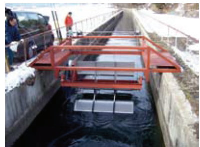
写真2-1 流水利用型発電設備
