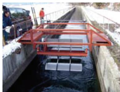
写真2-1 流水利用型発電設備
