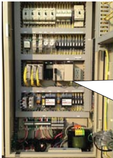
水管理システム制御盤
