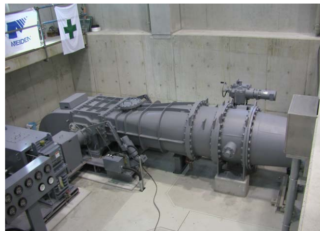
クロスフロー水車外観
