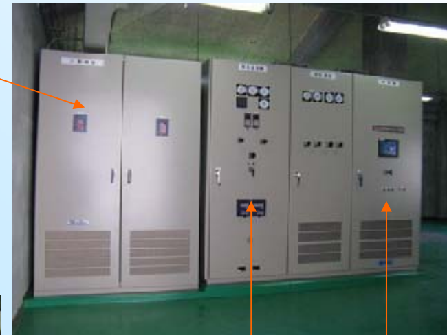
高压連系盤 制御盤
