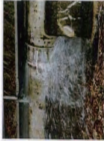
継目損傷により漏水したサイホン
