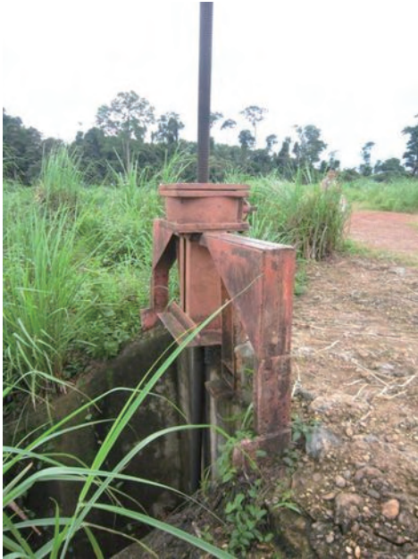
写真 43 取水口ゲート(補修前)
