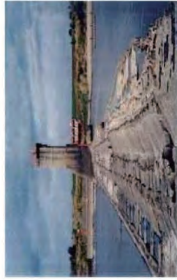
流水による侵食が著しい頭首工
