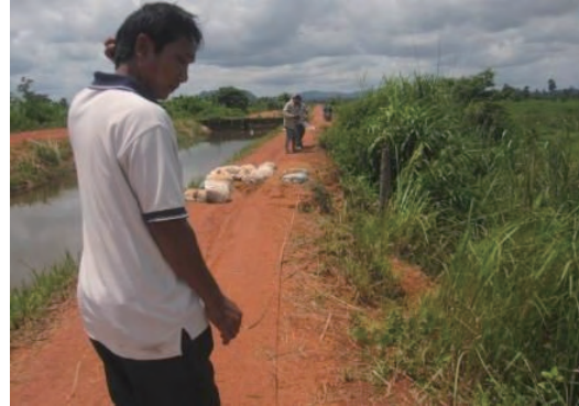
写真10 現地調査：水路堤の越流崩壊
