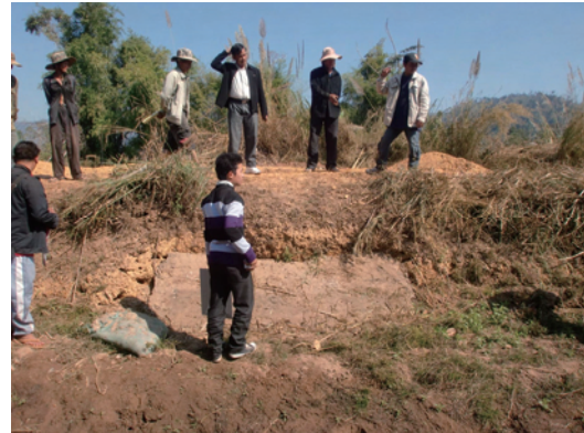
写真12 水路堤陥没部
