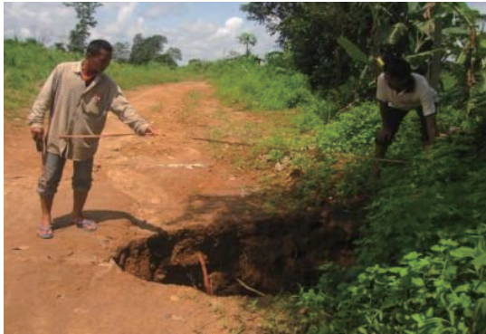
写真9 現地調査：水路堤の陥没
