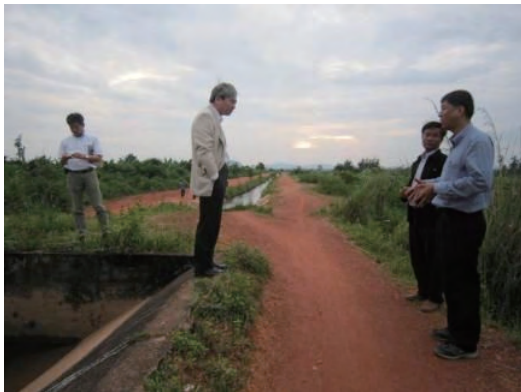
写真11 現地調査：水路堤の越流崩壊
