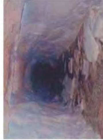
ライニングが崩落した水路トンネル
