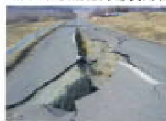
破損した農道(岩手県奥州市)
