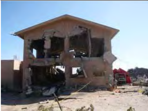
破壊された排水機場(山元町)
