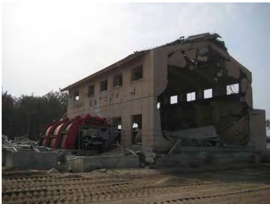
損壊した排水機場(山元町(6.10))
