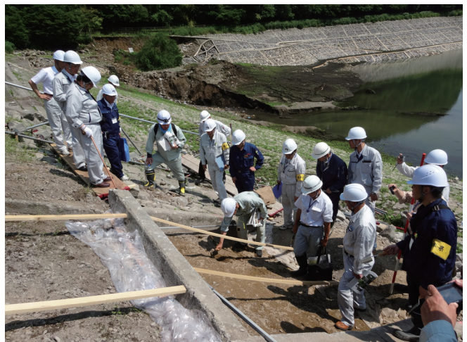
熊本地震による被災状況確認 (大切畑ダム、アースフィルダム)
