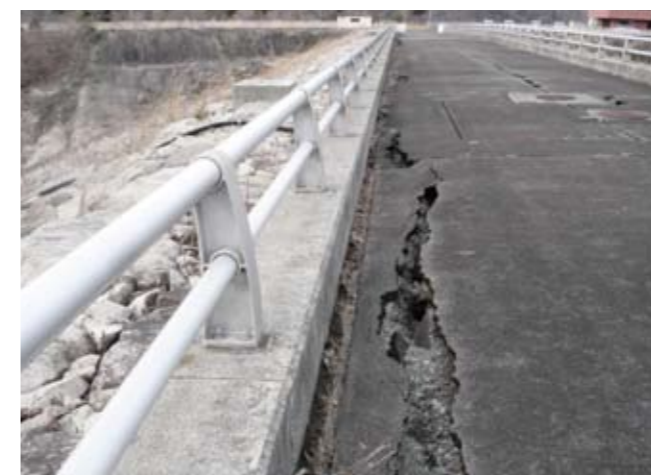
東北地方太平洋沖地震で被災した大柿ダム (ロックフィルダム：福島県)
